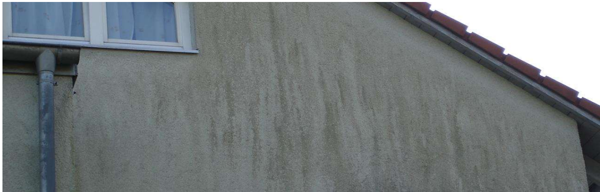
Algen und Pilze an einer Hausfassade
