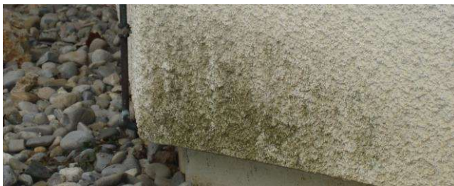
Algen und Pilze an einer Hausfassade
