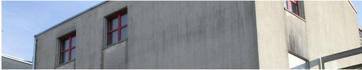
Fehlender Dachüberstand Foto: © Michael Burkhardt
